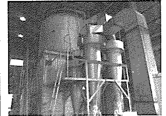
(噴霧乾燥機の廃熱活用)
